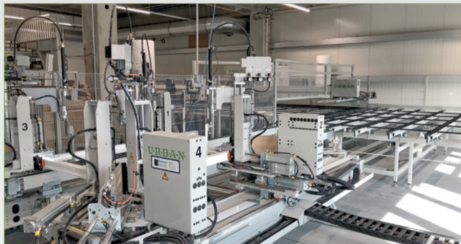
The AKS 6410/4 from Urban at Montagebetrieb Haß in Kiel.
